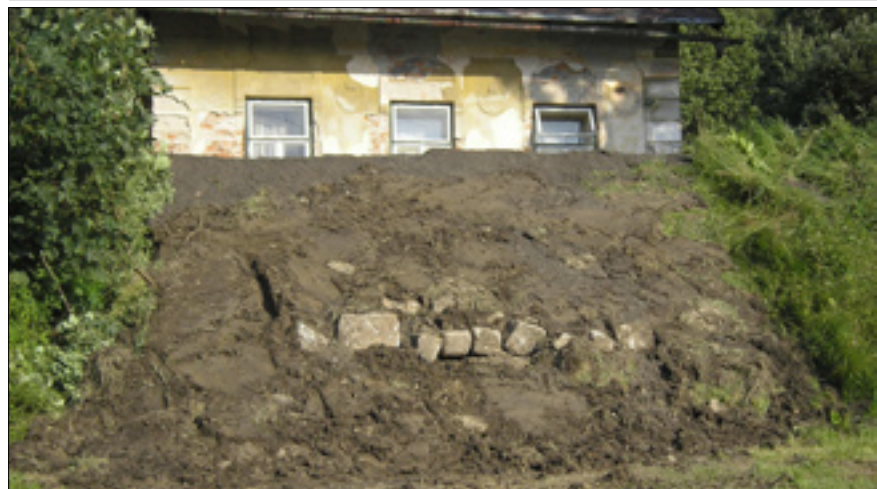
Deštěm podemletá utržená vozovka na Český Šumburk byla hned následující den opravena. Fotografie pořízené A. Liškovou jsou z 14. a 15. července 2008. -abr-
