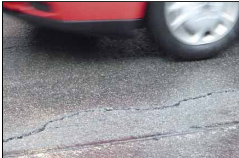
Na nové vozovce už se řidiči musí vyhýbat prasklinám. Foto: -hoš-
