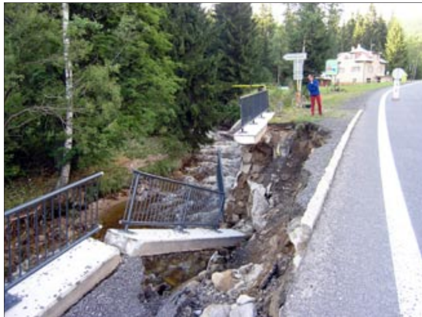
Harrachov - povodeň 2006. Takovouhle škodu dokáže nadělat říčka Milnice v Harrachově. (Foto: Ing. Fejklová)
